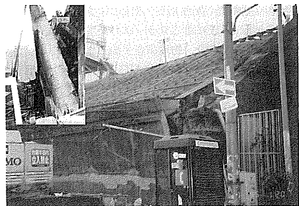
図-7.2 兵庫県南部地震で崩壊したL型擁壁
